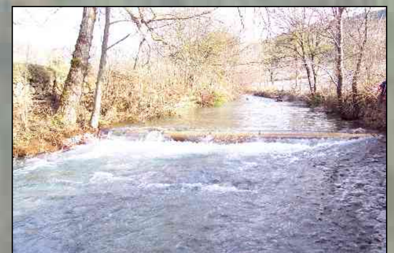
Mise en place de seuils pour diversifier le fond du lit sur secteur de dalle, permettant la reconstitution de zones de frayères pour les truites
