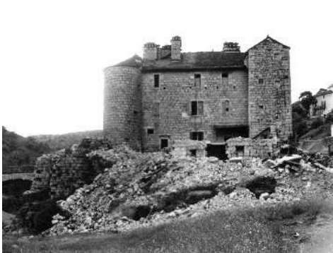
Façade orientale du château, travaux de démolition des bâtiments annexes en cours (1966). S.D.A.P. de la Lozère, repro. R. Soulier
