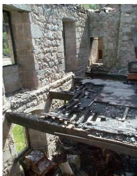
Plancher après incendie
