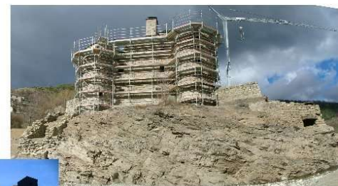
Mise en place échafaudage pour réalisation : Maçonneries: reprise blocs, cheminée, joints extérieurs, ... Elevation charpente bois Réalisation couverture lauzes schistes
