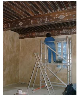
Reprise du décor peint sur plafond bois du niveau 1, et sur chaque élément : poutres, solives, lambrequins
